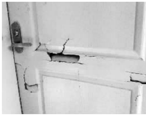
办公室木门被众人踹开,多处开裂凹陷
