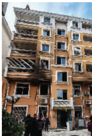
足浴店熏黑的外墙和破碎的玻璃 新华社记者 徐昱 摄
