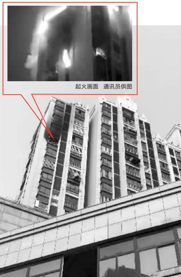
外墙大片已被烧坏、熏黑 通讯员供图
