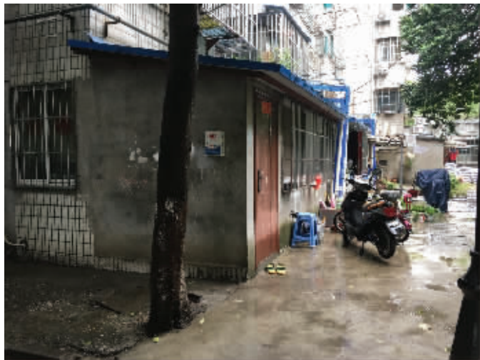
违建阻碍了小区出新搭脚手架
