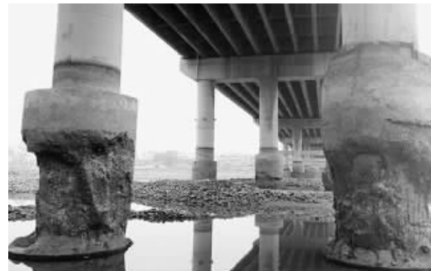
澧水大桥桥墩桩基外围混凝土脱落,支撑桥墩的外围钢筋也完全露了出来
