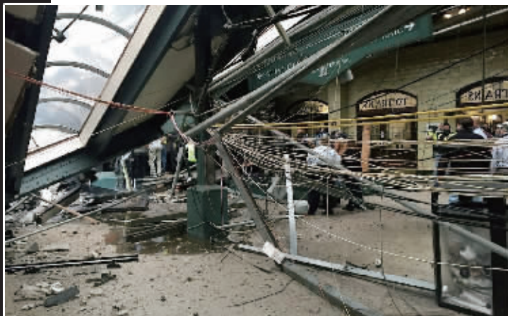
车站损毁严重
