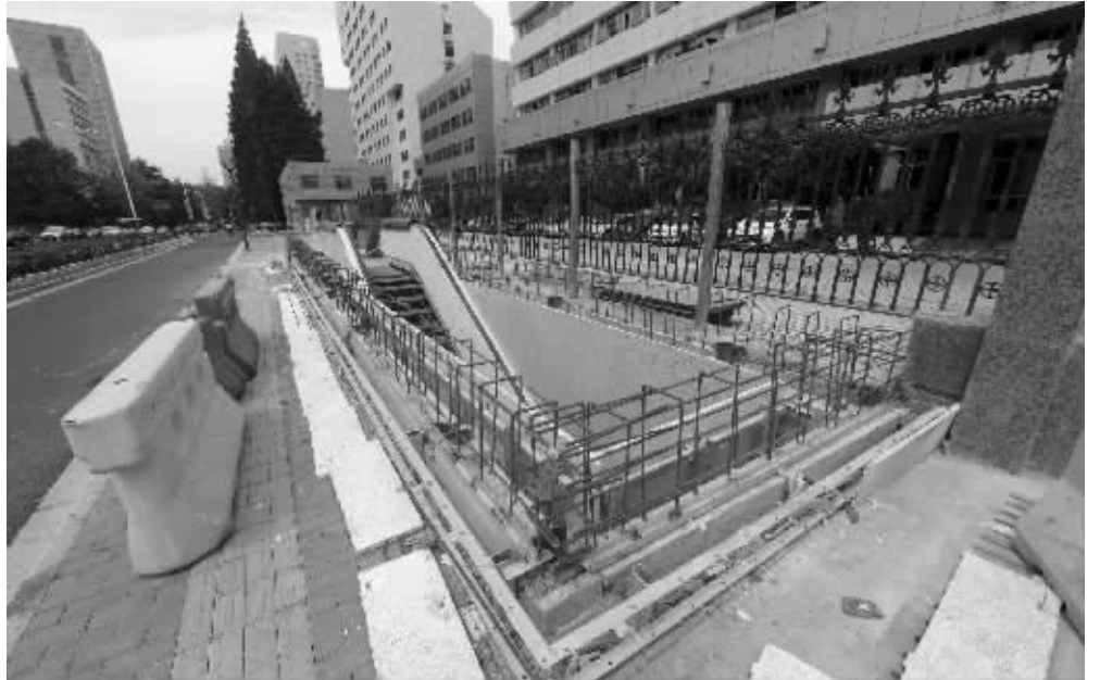
云南路站五号出口,雨棚被拆,还残留着钢筋骨架
