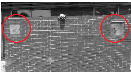
厕所入口处的凹凸标志已被拆除
