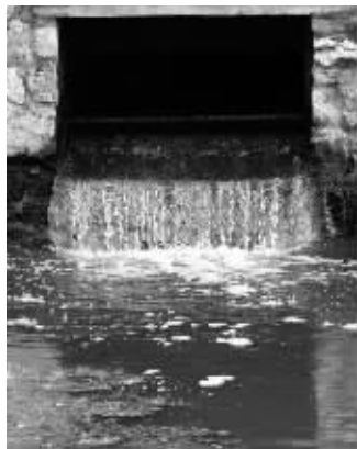
污水从排水口流向吨粮河
