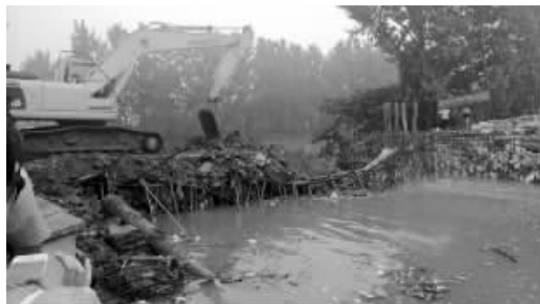
经过抢险人员的努力,溃堤缺口合龙
