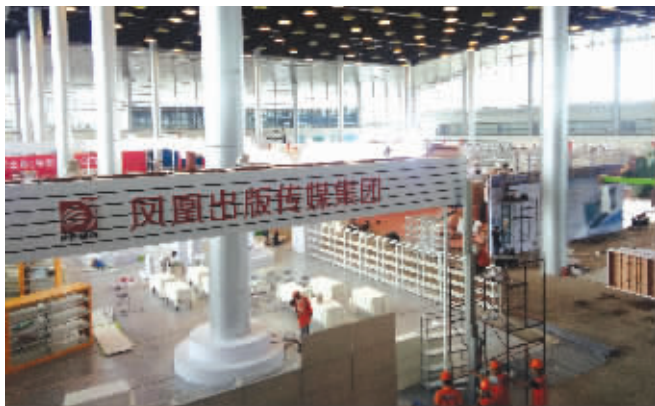
展馆装修昨天已基本完成 现代快报/ZAKER南京记者 臧晓松 摄
