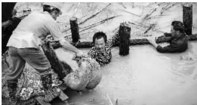
南京溧水和凤镇宕西圩,抢险人员在加固渗水的河堤 新华社发
