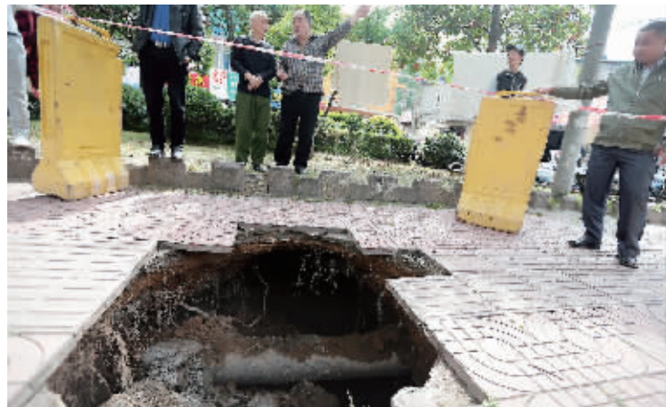
铁路北街人行道塌陷,出现大坑 现代快报记者 顾炜 摄
