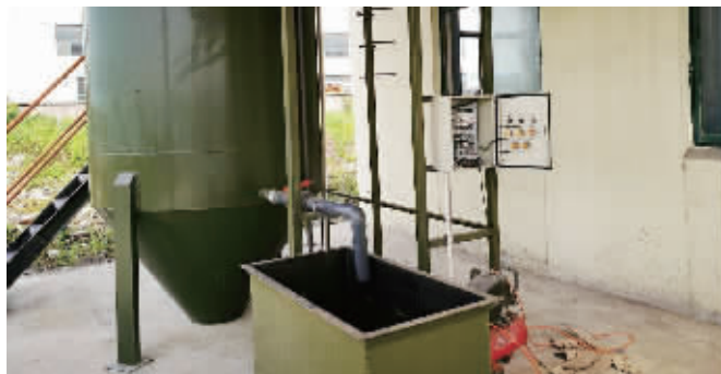
闲置未用的污水处理装置
