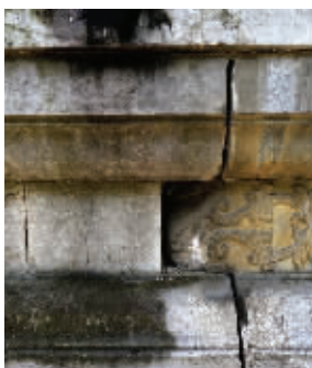
墙体出现裂缝,还有水渍和青苔
