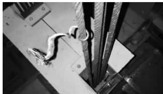
业主拍摄的电梯钢丝绳故障图片
