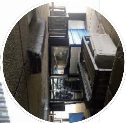
一业主在22层天井处搭了一个“空中楼阁”
