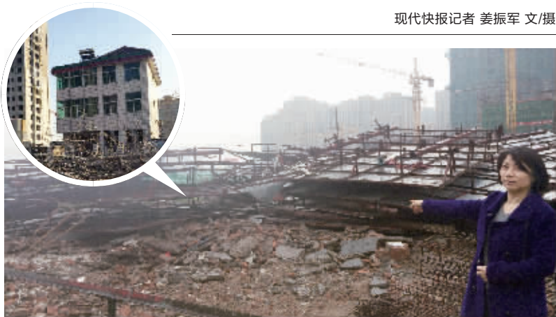
施女士家所在地已是一片废墟(小图为原来的三层小楼)
