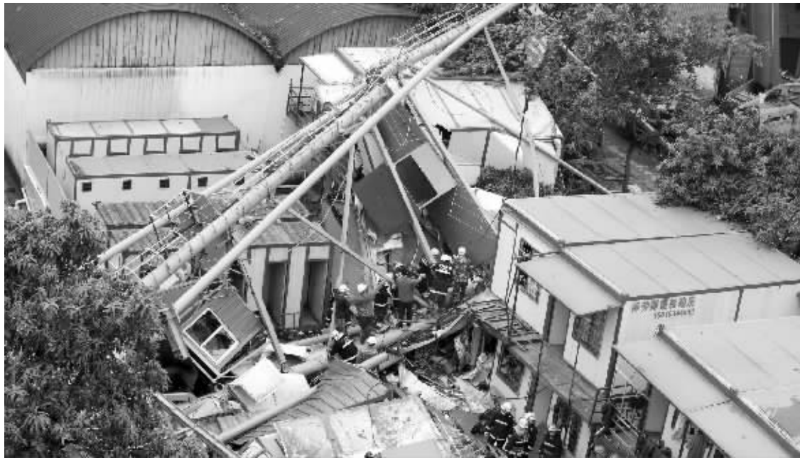
龙门架压垮临时集装箱房
