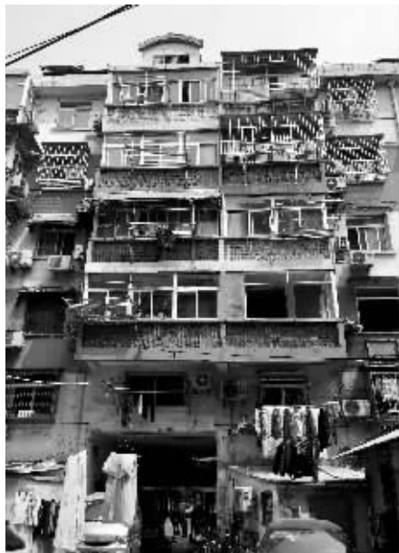
水西门大街127号楼房被评为D级危房 王益 摄
