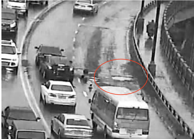
监控显示, 长江大桥路面出现破损
