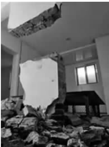
承重墙不可以拆除 资料图片
