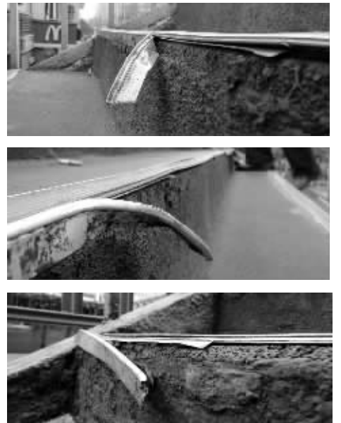
洪武路天桥和阶梯上已破损的防滑条 报料人徐先生供图
