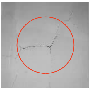
如果原先使用的是非耐水的腻子粉,会比较容易造成墙面开裂、脱皮、粉化等问题 资料图片
