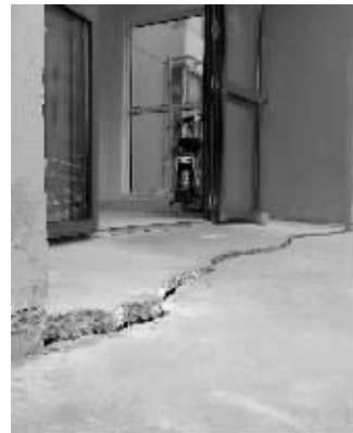
居民楼前的裂缝
