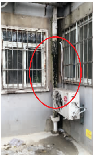
小区大部分落水管已损坏
