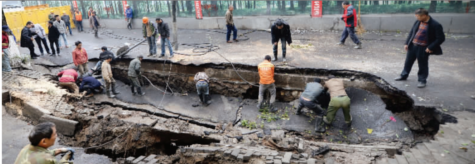
昨天早晨, 北京东路半个多月来第5次发生塌陷 现代快报记者施向辉摄
