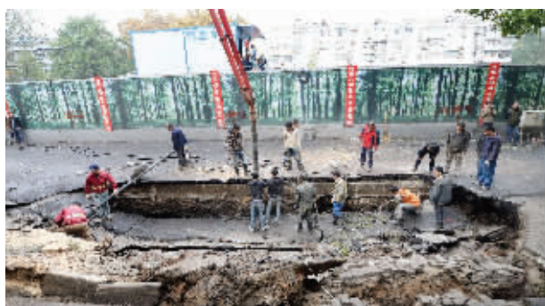
这次塌陷和上次在同一路段 现代快报记者 施向辉 摄
