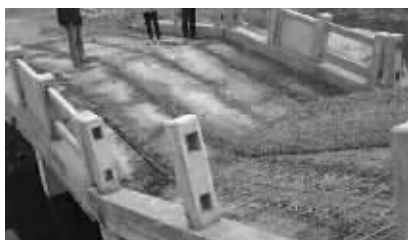
网传断桥现场图片(请供图网友来领稿费)
