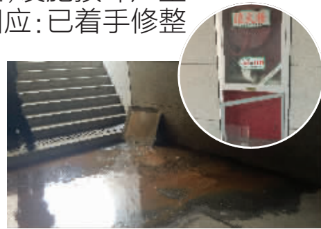
地下通道里污水横流,设施损坏严重
