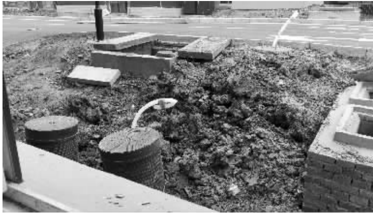
窗外的路面要高出室内地面不少
