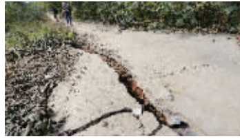
河堤上简易水泥路开裂严重
