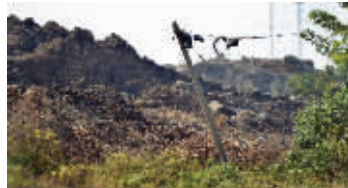
河堤上电线杆严重倾斜
