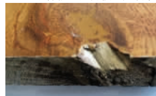
地板出现开裂损坏
