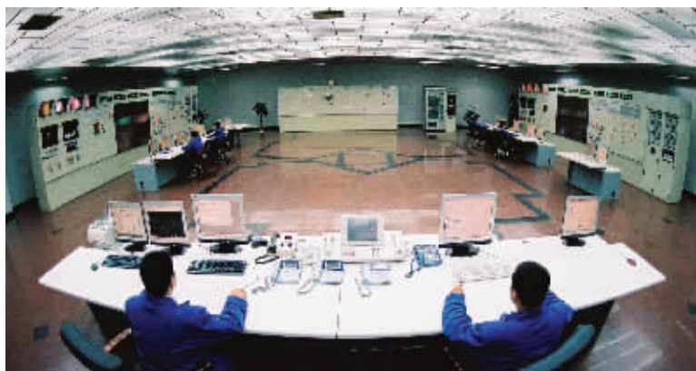
发电公司集控室
