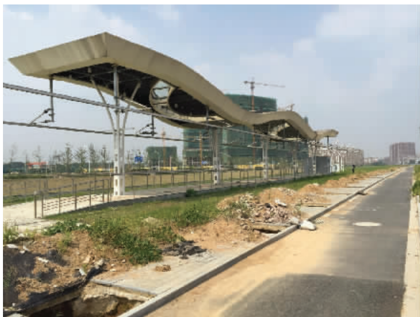
麒麟人民期盼已久的有轨电车已停工多时,工地长满杂草
