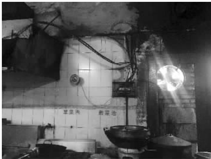
小餐馆蒸锅上面就是电线
