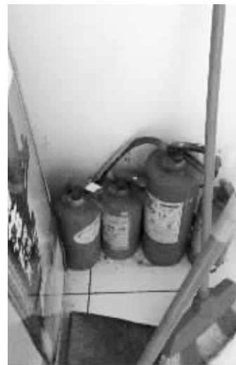
角落里的灭火器,落满了灰
