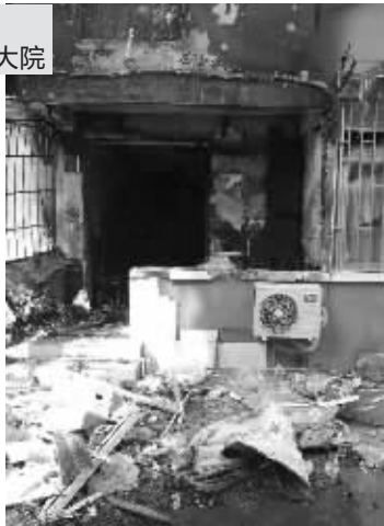
厨房爆炸人家的阳台墙壁倒塌
