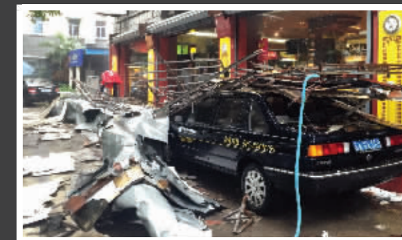
洪武路一家烟酒店门头在大风中坍塌
