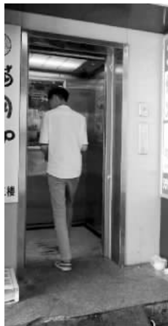
发生故障的电梯
