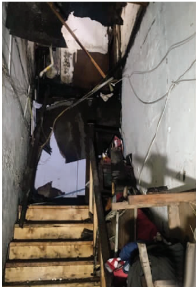
坍塌的楼板下方是通往二楼楼梯 (请供图者来认领稿费)
