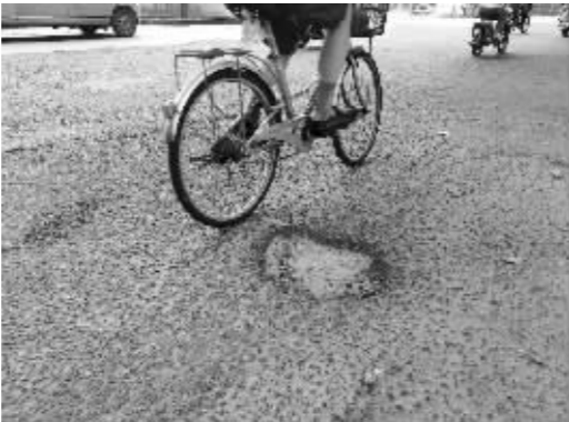
中山东路南半幅路面坑坑洼洼,行人苦不堪言
