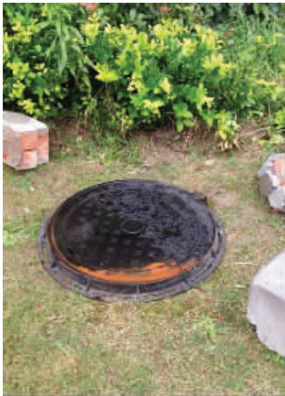
出事的窨井已更换了新井盖 映过多次,也不见改善。”
