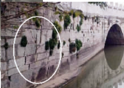
裂缝最宽的有1厘米(南京市文广新局提供)
