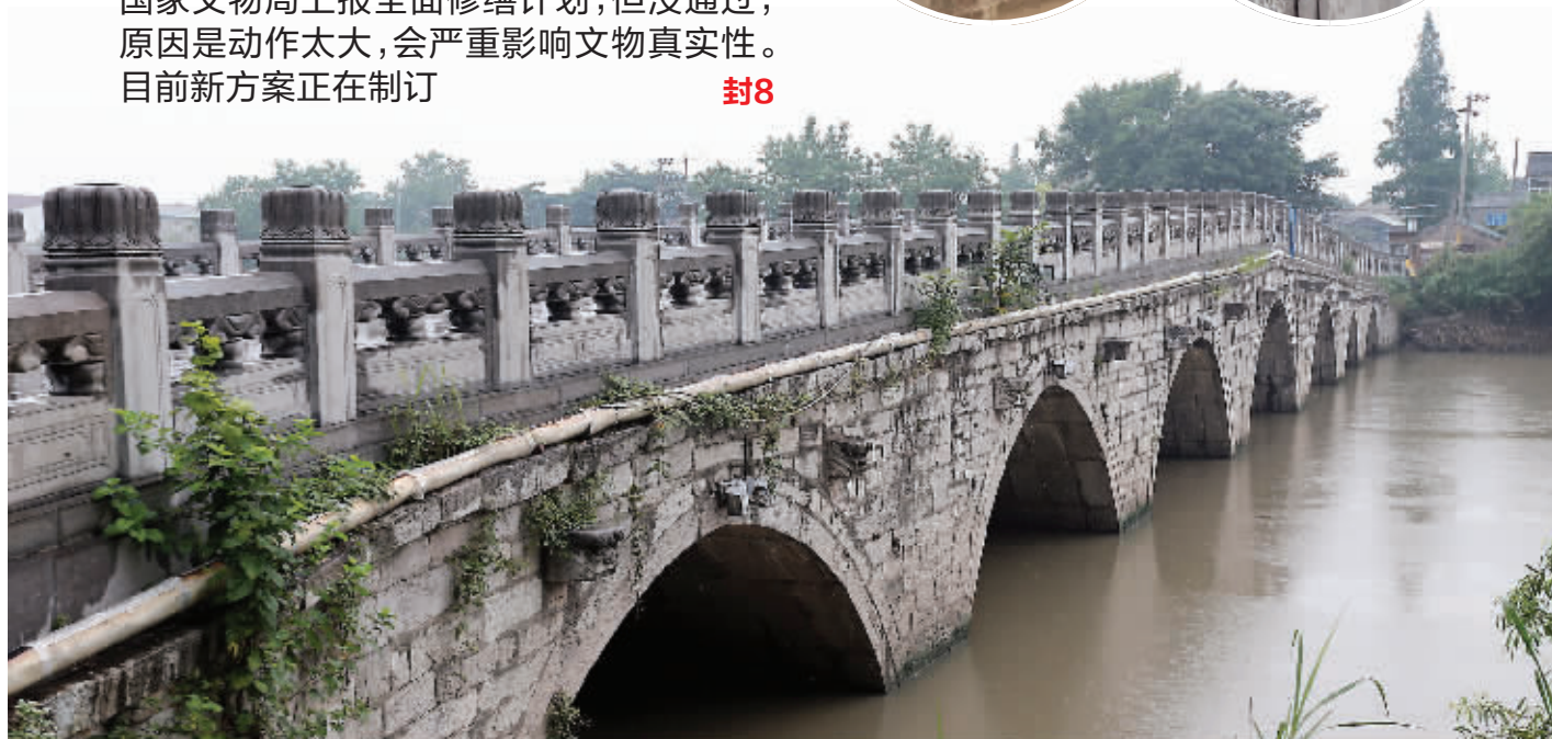
七桥瓮桥体多处出现裂缝 现代快报记者 顾炜 摄
