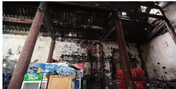
李公祠破损漏雨 现代快报记者 顾炜 摄
