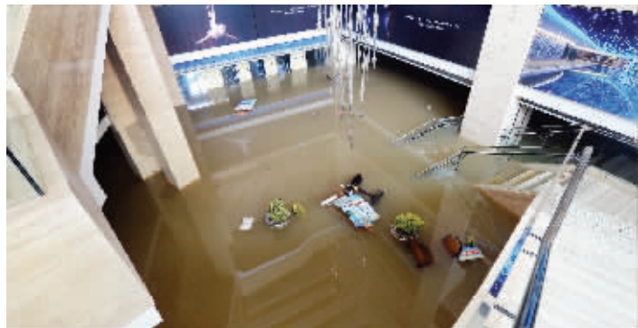
藏龙御景小区会所地下层泡在水中,损失惨重 现代快报记者 施向辉 摄
