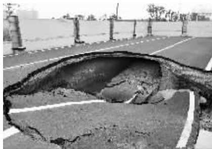
邺城路路面坍塌,出现一个大坑 现代快报记者 徐洋 摄
