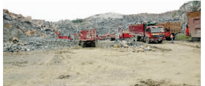
丹阳市丹北镇管山村附近一处施工现场,有不少外运石料的车辆
