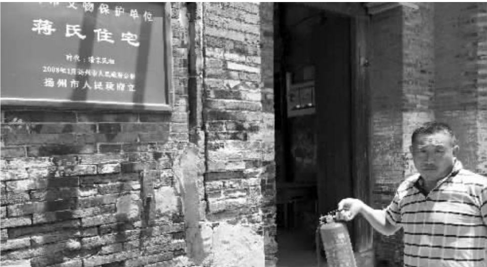
蒋氏故居的灭火器已经无法使用
