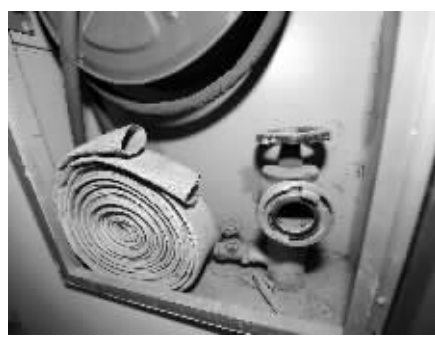
消防设施是坏的 现代快报记者 施向辉 摄
